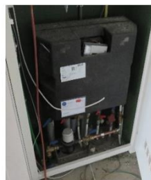
HT-warmtenet Afleveret voor zowel verwarming als warmtapwater
