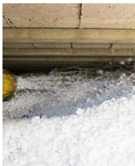
Vloerisolatie op de bodem van de kruipruimte
