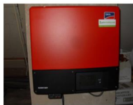
De stroom die door de zonnepanelen wordt opgewekt komt binnen via een omvormer en wordt aangesloten op een groep in de meterkast
