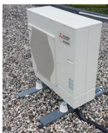
De buitenunit van de warmtepomp
