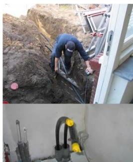
De leidingen vanuit de bron moeten via spargen de woning in.
