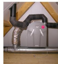
Ventilatie box op zolder
