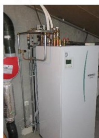
Dit is het gedeelte van de warmtepomp die binnen komt te staan.
