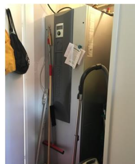
De warmtepomp is circa 0,9 x 0,9 x 2,1 m.
