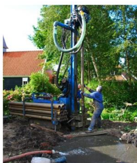
De bron voor de bodem/water warmtepomp moet gerealiseerd worden.
