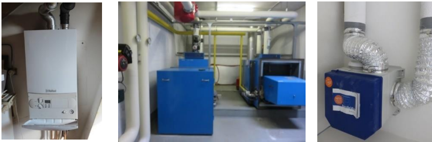
Figuur 30: Installatietechnische componenten: individuele CV-ketel, collectieve CV-ketel en ventilatie-unit
