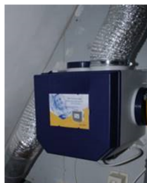
Een MV-box zorgt voor de afzuiging van lucht uit de keuken, badkamer en het toilet.
