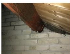
Luchtlekken tussen dak en bouwmuur
