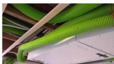
Kanalen in een verlaagd plafond
