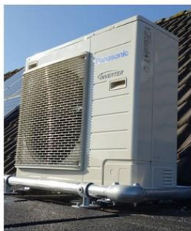
De buitenunit op het dak
